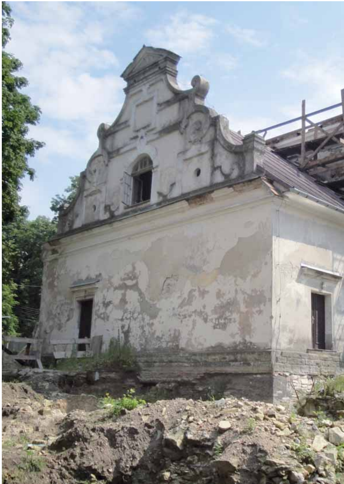
Ilustracje 2-1. Gardzienice, dwór — zachowana część ze szczytem manierystycznym — widok od północy. Fot. M. Brykowska, 2011
